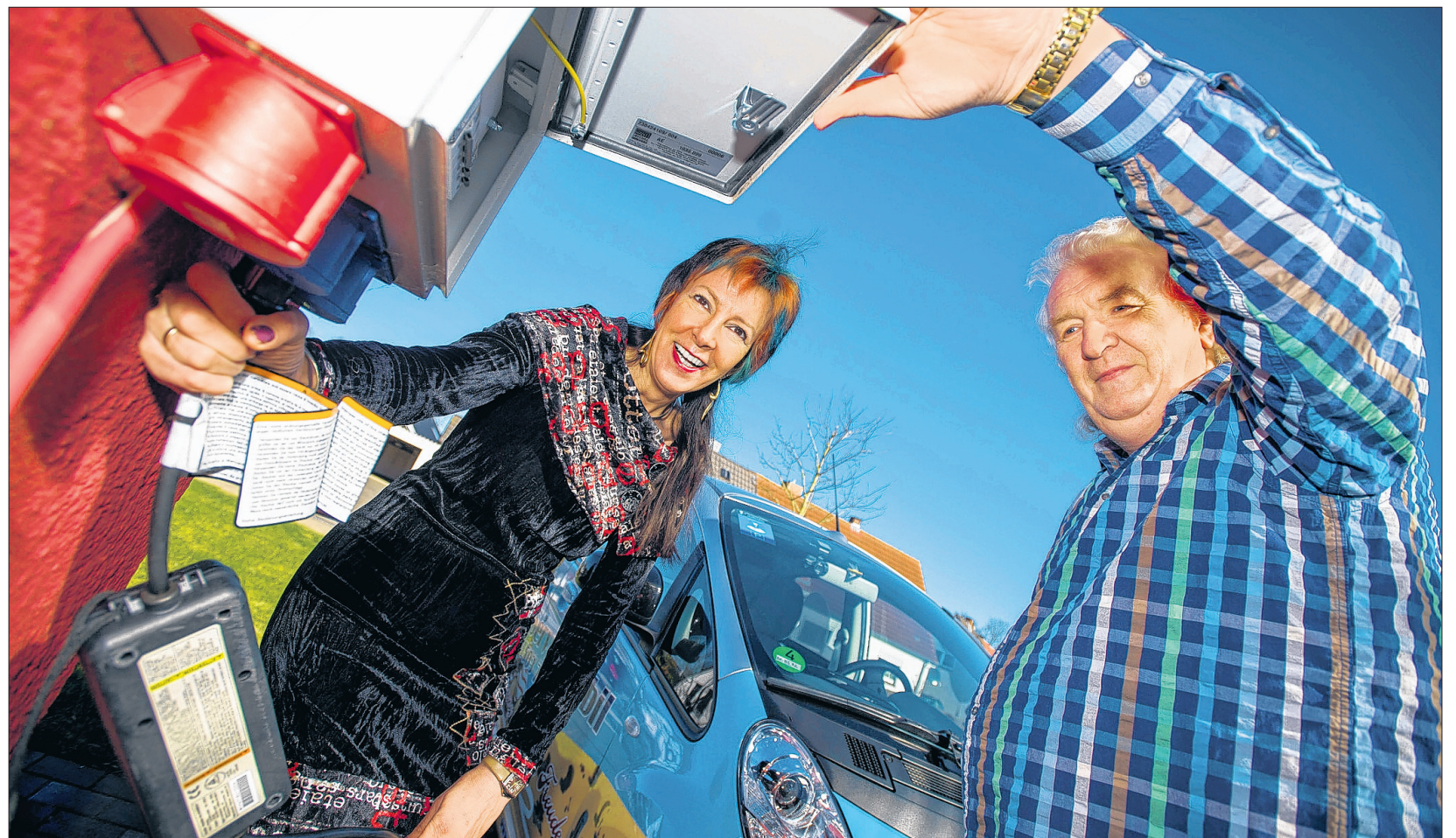
Sie fahren schon seit 16 Jahren Elektroautos. Deshalb war für Christel und Peter Sörensen aus Ratekau klar: Wir brauchen unsere eigene E-Tankstelle auf dem Grundstück.
